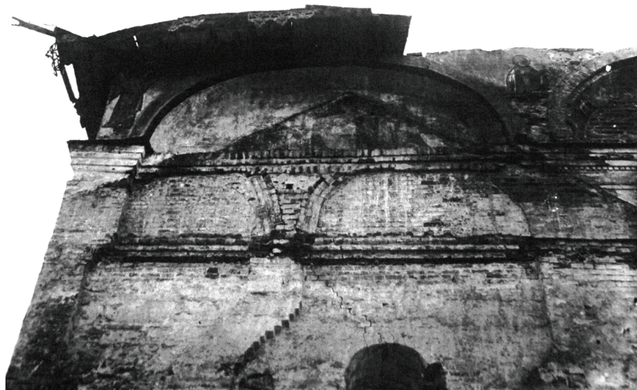
Рис. 6. Фото фрагмента северной стенки (западная часть) после разрушения придела вмч. Федора Стратилата в 1934 г. Видны следы первоначальных закомар. ГНИМА. V-5110
